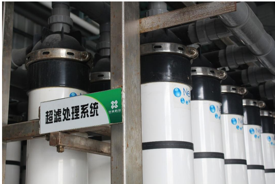
Figura 4: Detalle del equipo de ultrafiltración
