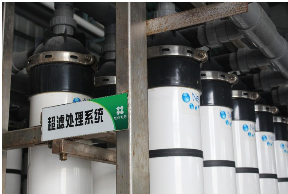
Figura 4: Detalhe do equipamento de ultrafiltração
